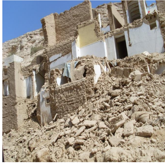
صورة ( 5 ) تهدم الأساسات وسقوط المبنى
