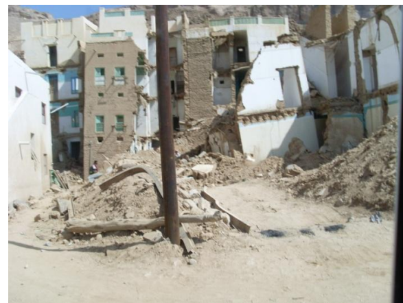
صورة ( 7 ) تهدم الجدران الحاملة ومن تم تهدم المبنى
